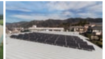
バス営業所に設置した太陽光パネル
