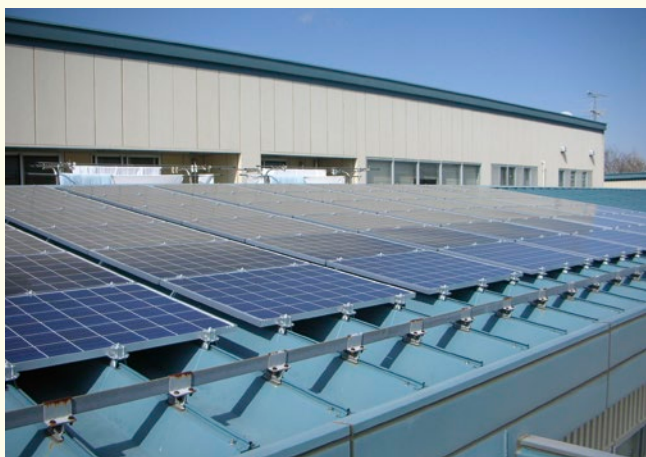
神奈川中央交通の相模原営業所事務所棟屋根上に設置した太陽光発電パネル（神奈中商事）
